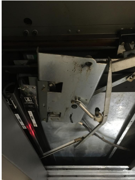
Figura 4. Dano ao operador e rampa
