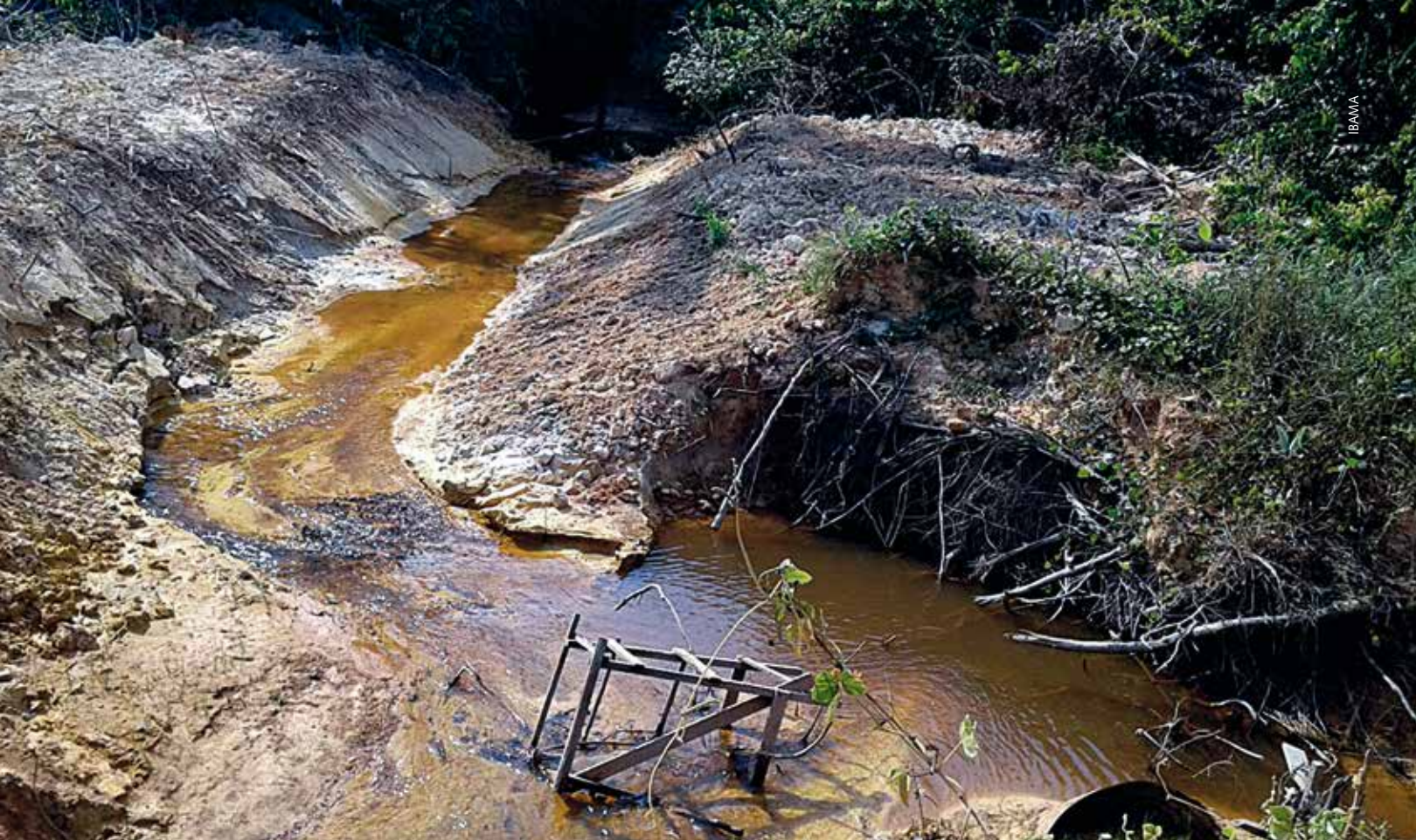
Igarapé assoreado pela polêmica obra na BR 319: Para liberar obra, Dnit prometeu reparar danos
