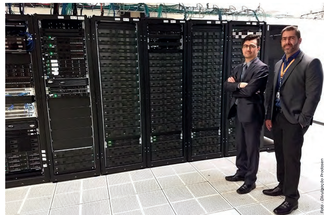
Alessandro Albuquerque, diretor do Prodasen e André Molina, coordenador de Infraestrutura de Tecnologia da Informação: nova estrutura de data center
